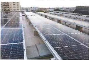
屋上太陽光パネル 63kw を発電
